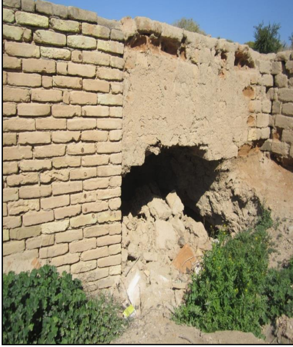
الصورة (٢٨) جانب من انهيار بعض جدران مدينة بابل بفعل تجمع مياه الأمطار
